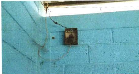
Foto 12: Se observa sistema eléctrico con instalación inadecuada.
