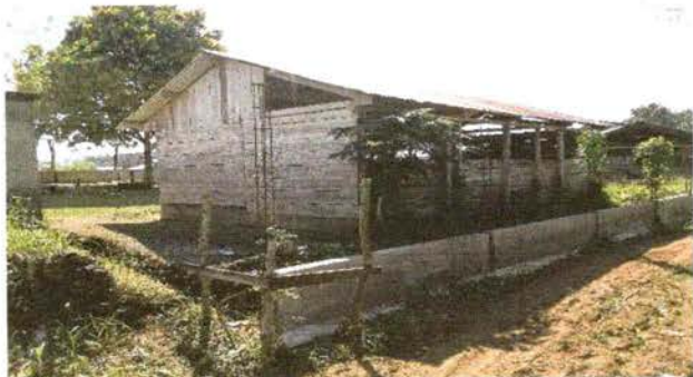
Foto 1: Se observa pared inconclusa.
