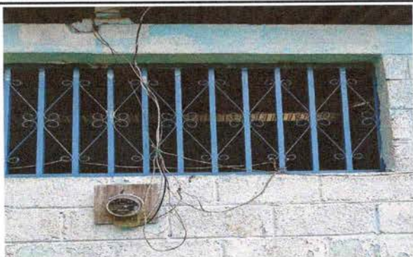
Foto13: Se observa cableado eléctrico desorganizado.
