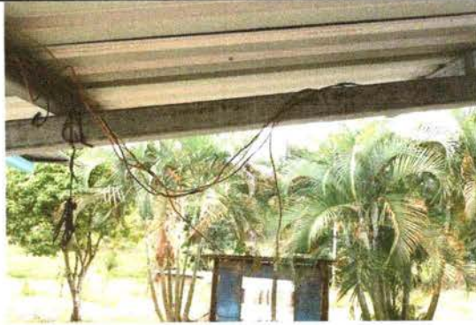
Foto 14: Se observa cableado eléctrico expuesto.
