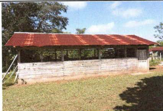
Foto 2: Se observa techo en mal estado.
