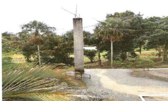
Foto 8: Se observa desperdicio de líquido por grieta en el depósito.
