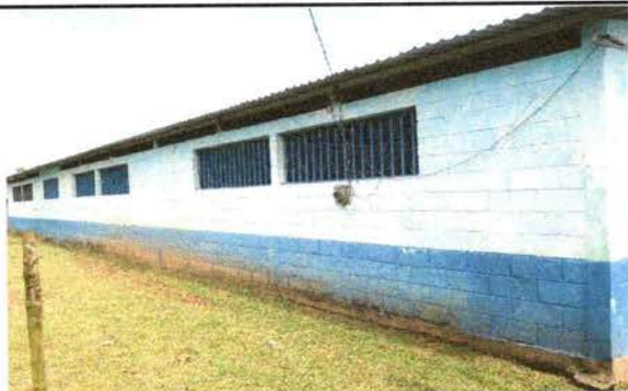
Foto 5: Se observa pintura deteriorada.
