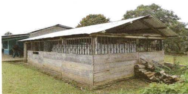
Foto 11: Se observan balcones en mal estado en el área de cocina, no se contemplaron paredes por falta de presupuesto en base a la priorización de necesidades del establecimiento.
