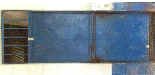
Foto 9: Se observa puerta en mal estado.
